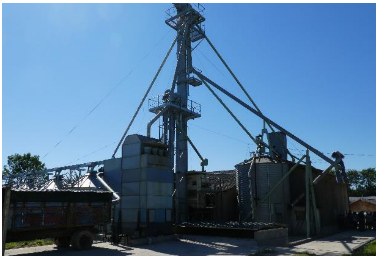
Installation de triage - vue extérieure : Pont bascule, cellule de chargement, séchoir, trieur rotative...
