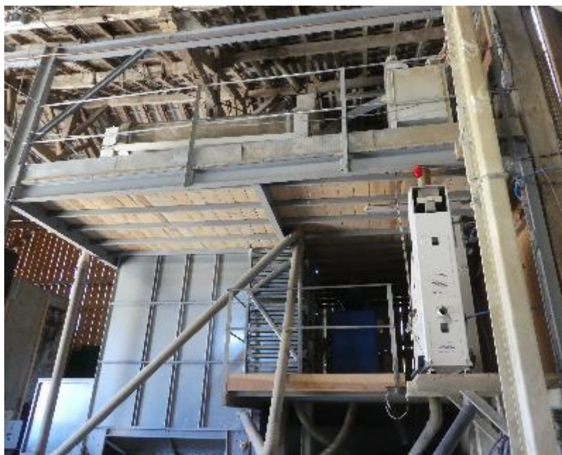
Installation de triage vue intérieure (trieur optique sur la droite)
